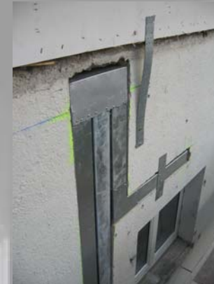
Lüftungskanäle in Wand
